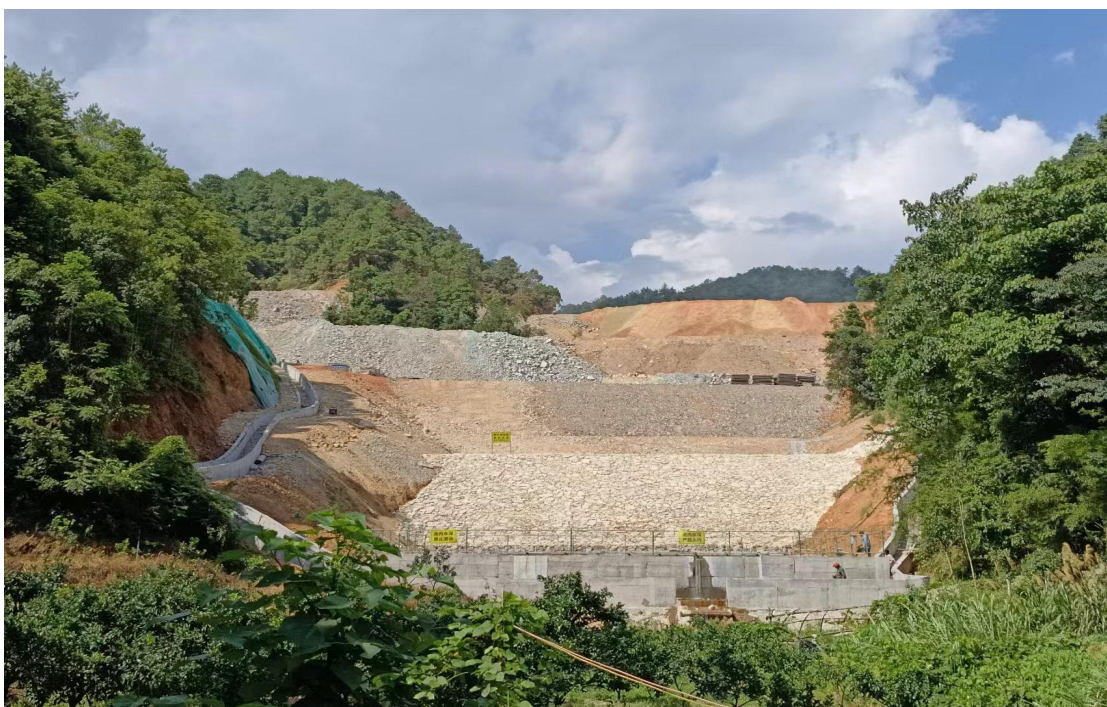
拦挡坝及沉淀池
