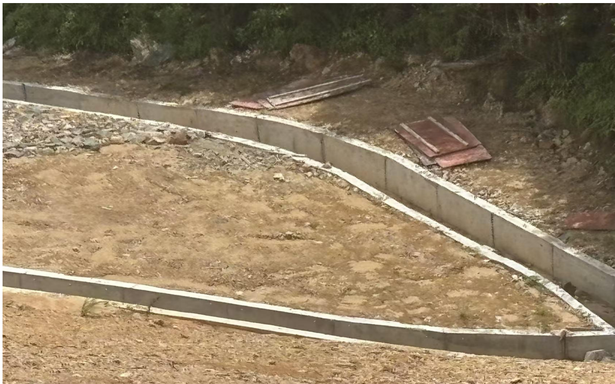
弃土场截排水沟
